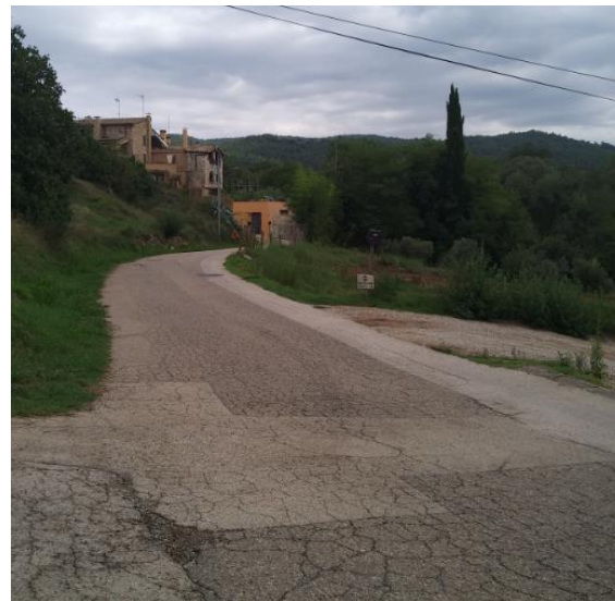
Paviment en mal estat al carrer Tambor Ansò
