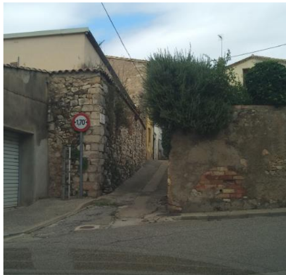
Paviment en mal estat al carrer S.XVI
