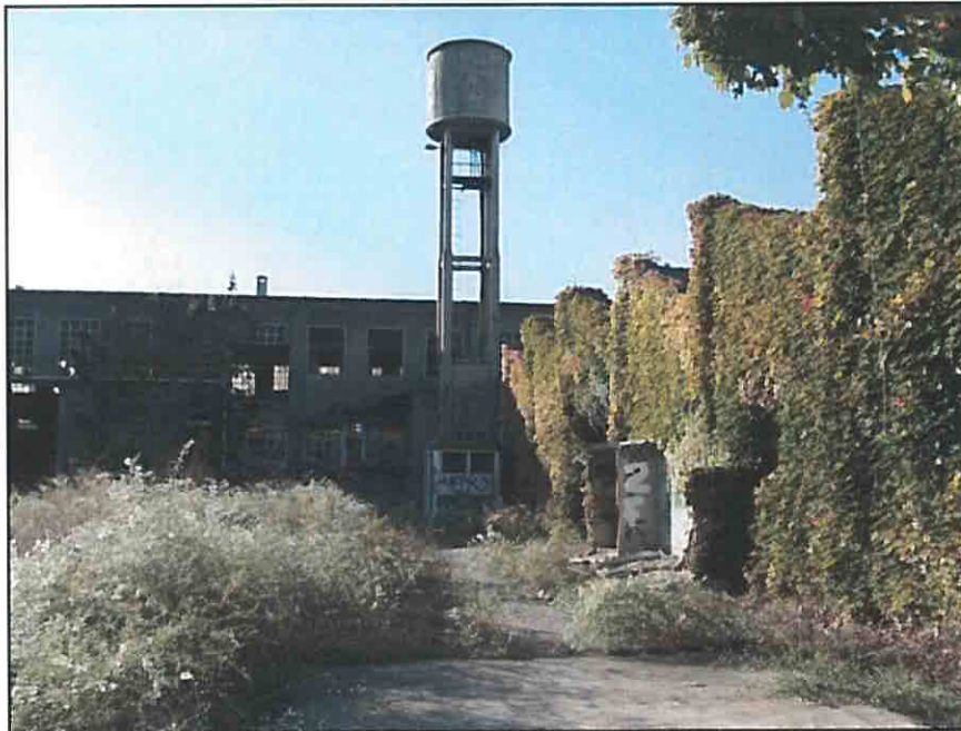
Foto 5. PAU-117. Abandonament de naus. Manca de salubritat i seguretat.
